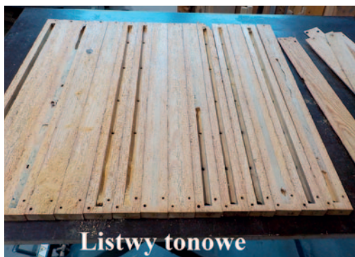
zniszczenia listew tonowych – fot. A. Sutowicz
