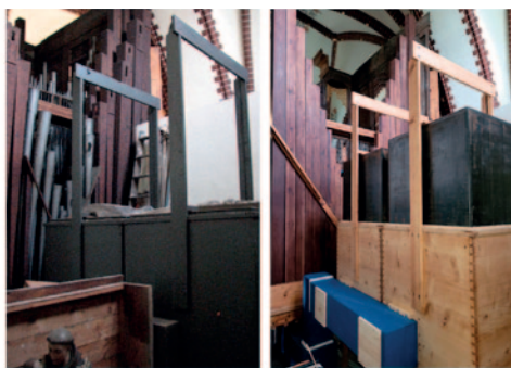
Miechy skrzyniowe przed i po renowacji
