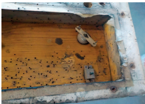
ślady intensywnego żerowania szkodników (po oczyszczeniu z pyłu) – fot. A. Sutowicz
