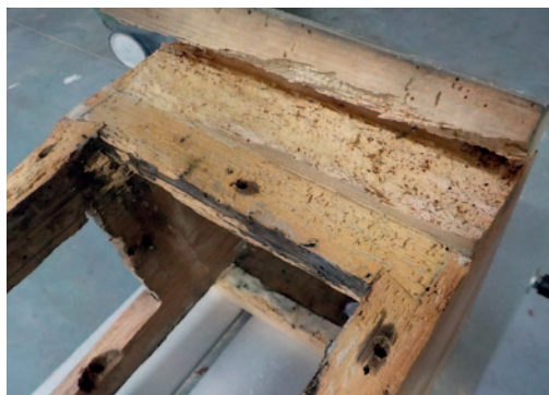
zniszczenia fragmentu wiatrownicy rejestrowej – fot. A. Sutowicz
